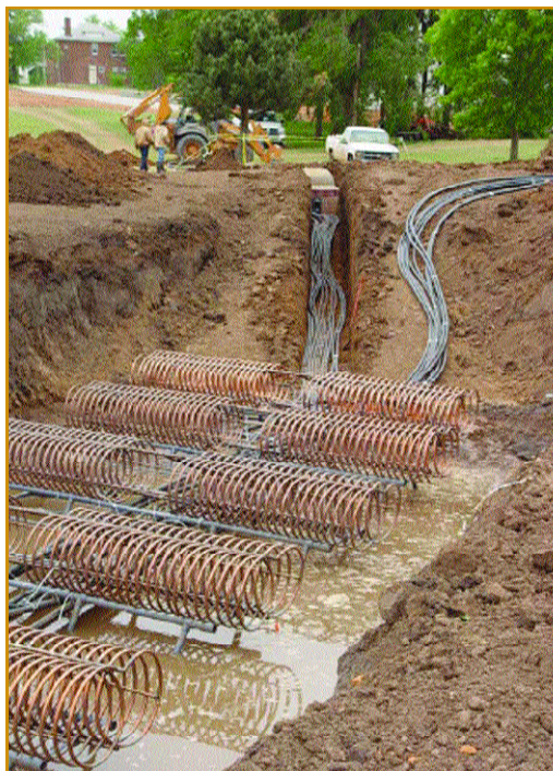
Detalle de colectores geotérmicos de un aprovechamiento en un futuro estanque artificial
